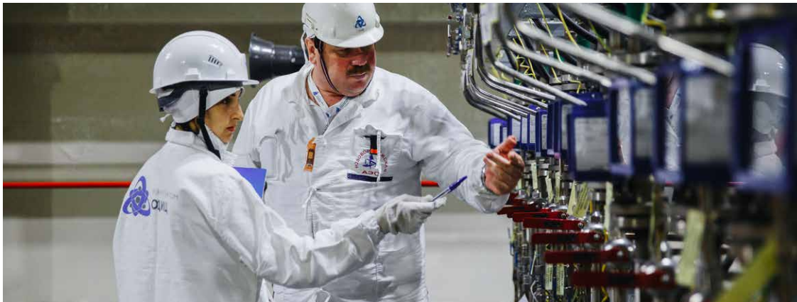
Опытно-демонстрационный инженерный центр по выводу из эксплуатации. Комплекс плазменной переработки. Операторы снимают показатели расхода воды на КПП РАО.
